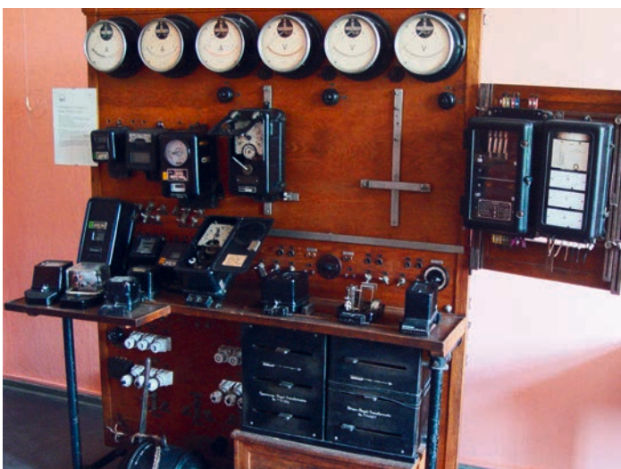
Zähler- und Relais Prüfplatz aus dem ehem. Museum Kraftwerk Hirschfelde, AEG, Bj. ca. 1930, 2017
