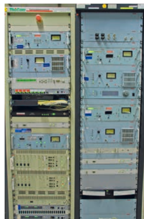
UKW-Sender und Steuerungseinrichtungen in Weimar Belvedere im ehemaligen Stationsgebäude.
