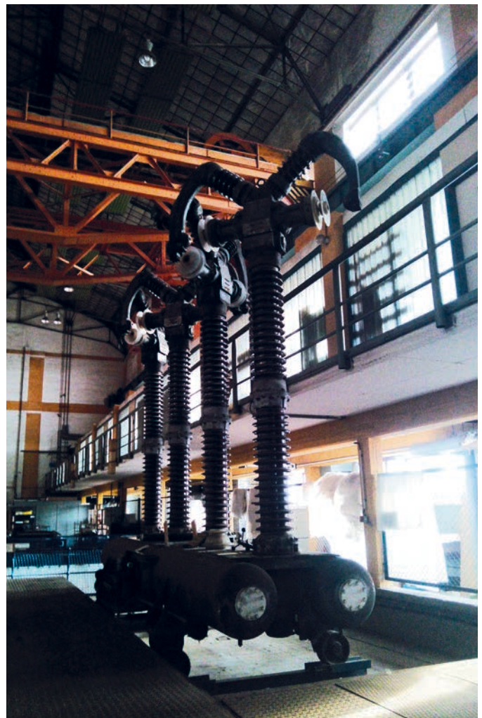
220-kV-Freiluft-Hochspannungsleistungsschalter im ehem. Museum Kraftwerk Hirschfelde, AEG, Bj. 1959, 2017
