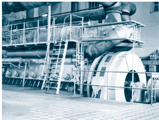
Dieselaggregat 2 (2,5 MVA Generatorleistung) der Dieselskraftanlage Mühlhausen, rechts im Bild der Drehstrom-Synchrongenerator mit Erregermaschine
